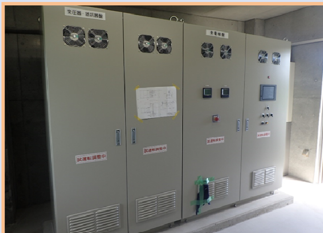
系統連系盤/操作盤
